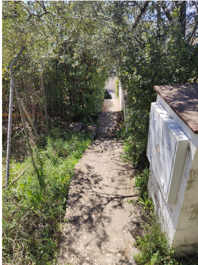
Servicios existentes de electricidad
